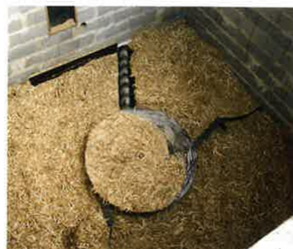
Die Rührpaddel befördern das Häckselgut in die Zuführschnecke zum Heizkessel.
