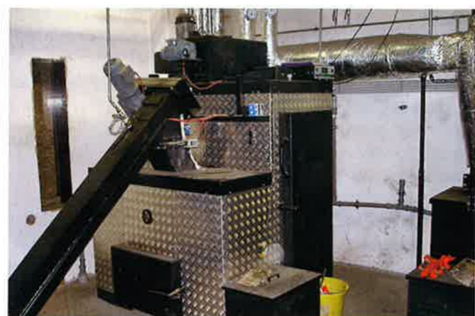
Die 160-kW-Hackschnitzelheizung auf dem Betrieb Lux verbrennt den Miscanthus problemlos. Das Material muss nur kurz genug sein, damit es in den Förderschnecken nicht stopft.
