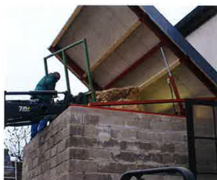
Der Vorratsbunker neben dem Heizungsraum fasst 30 m³. Die Ballen werden mit dem Frontlader hineingehoben und von Hand aufgelöst. Zehn Ballen reichen etwa für zwei Wochen.
